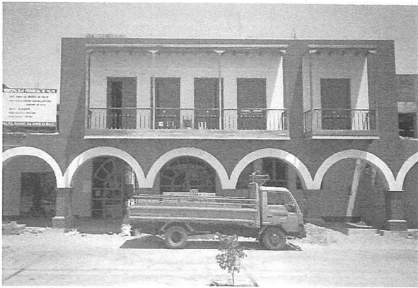
Abb. 20 Bauarbeiten im Obergeschoss des Rathauses von Palpa, wo das archäologische Lokalmuseum eingerichtet werden soll.
