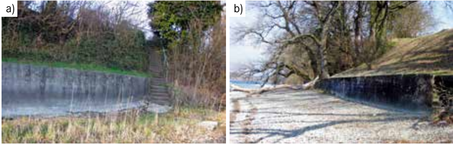
Abbildung 2: Ufermauer am Bodensee-Untersee – Szenario B: (a) südostexponierte Stützmauer an einem erosionsgefährdeten Uferabschnitt südlich Hornstaad mit einer Vorland-Vegetation aus schüttereren Schilf- und Rohrglanzgrasbeständen; deutlich zeichnen sich die vorjährigen Maximalwasserstände ab (Gemarkung Horn; Foto: 30.03.2011, W. Ostendorp); (b) nordexponierte Stützmauer in Mammern (Spanacker); infolge der Beschattung durch Bäume ist das Vorland nahezu vegetationsfrei (Foto: 25.03.2011, W. Ostendorp).
